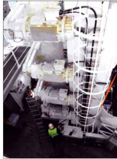
Abbildung 7: Hubbeine von außen. Blick auf 4 Elektromotoren zum Antrieb. (Foto: Dr. Hochhaus)
