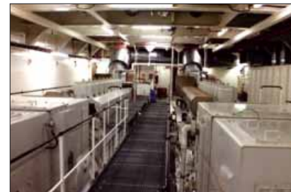
Abbildung 19: Zylinderstation der zwei von insgesamt vier Dieselegeneratoren. (Foto: Dr. Hochhaus)
