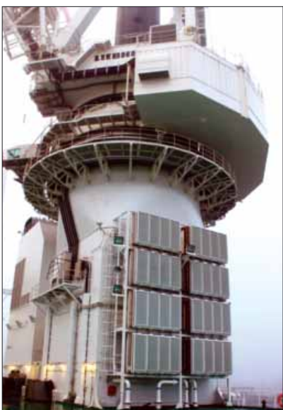
Abbildung 14: Blick auf den Kran mit integriertem Hubbein und 8 der 16 Luftkühlern. (Foto: Dr. Hochhaus)
