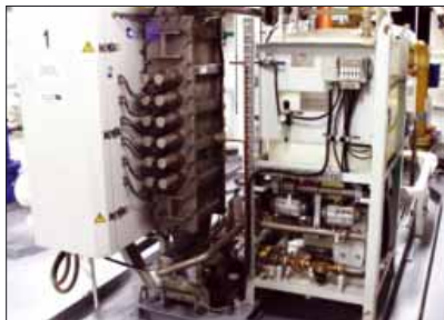
Abbildung 21: Ballastwasseraufbereitung, AOT-Einheit mit den UV-Lampen. (Foto: Dr. Hochhaus)
