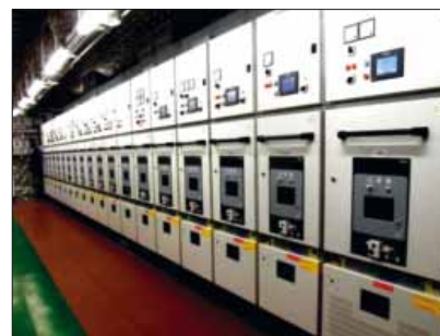
Abbildung 5: Mittelspannungs-Schalttafel. (Foto: Dr. Hochhaus)
