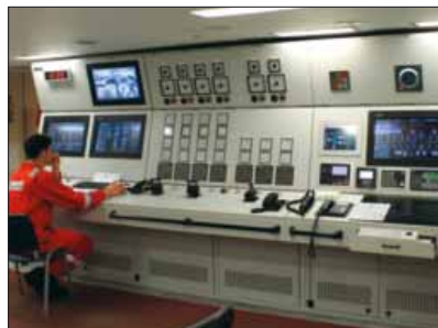
Abbildung 11: Der Maschinenkontrollraum befindet sich unter Deck. (Foto: Dr. Hochhaus)
